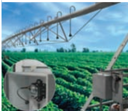
Kontrola brzine svakog motora na sistemu za navodnjavanje radi sinhronizacije
